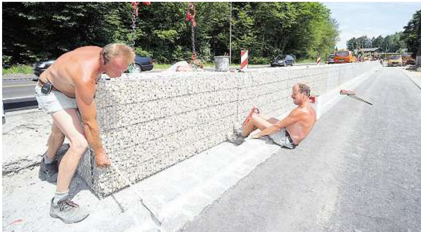
Kraftakt mit Feingefühl: Korb für Korb haben die Arbeiter gestern an die Westliche Ringstraße gesetzt, der Lärmschutzwand nimmt Formen an. Die feinen Steine sollen den Schall besonders gut schlucken. Foto: Herbert
